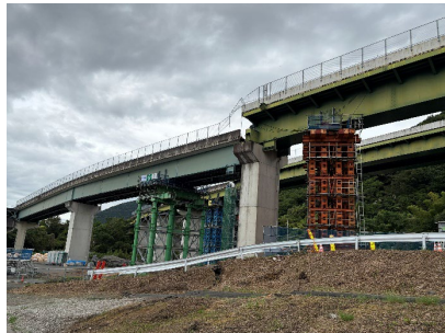
八代 JCT 付近の高速道路橋脚のズレ
