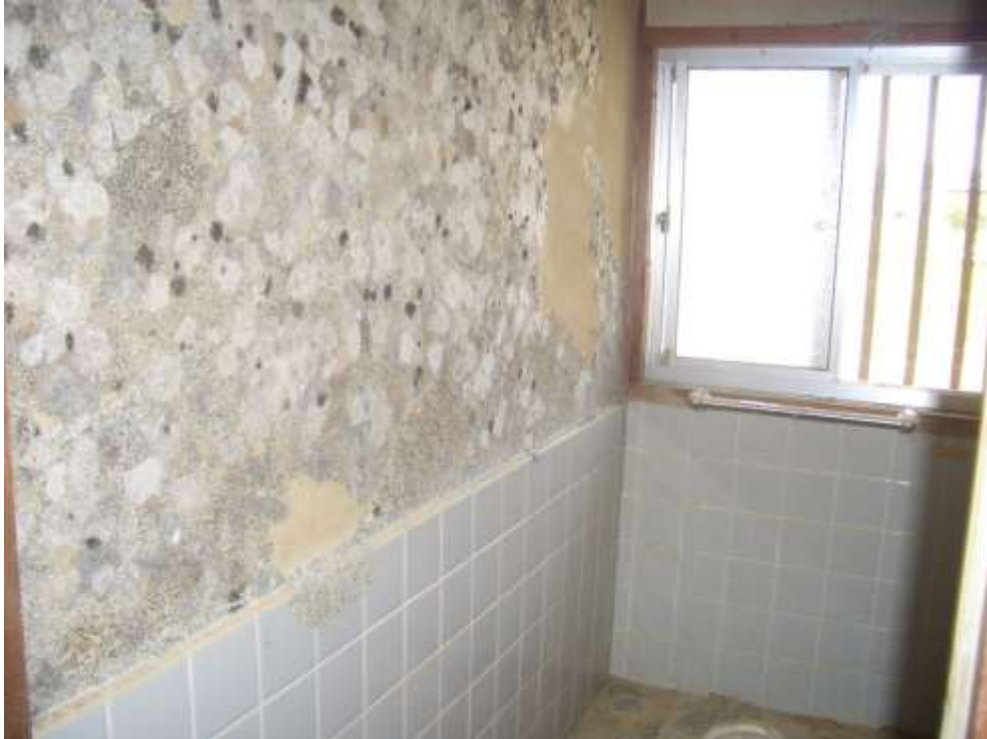
1 階のトイレ。壁に浸水の跡。
