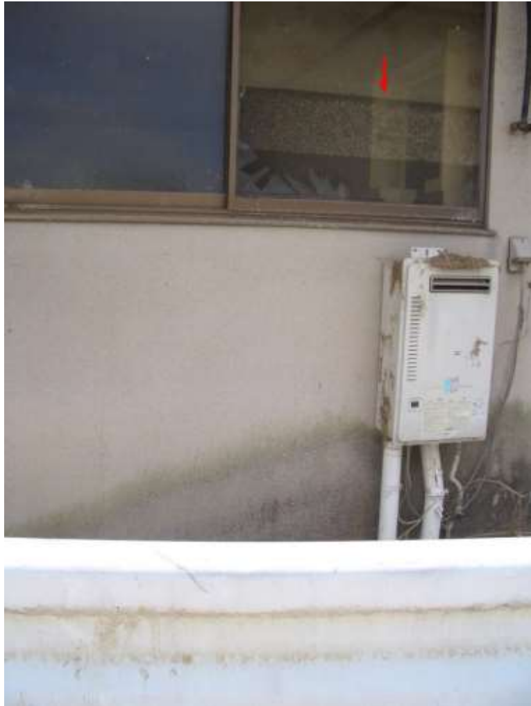
窓ガラスの約2.5mの高さに残る浸水跡
