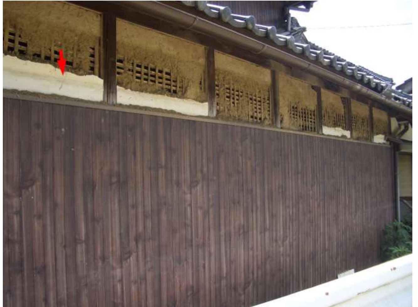
土壁に残る浸水の跡、土壁は流されている
