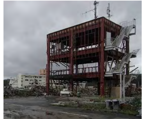
宮城県南三陸町 防災庁舎
